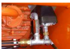
Рис. 80: Выключатель воздушного компрессора
